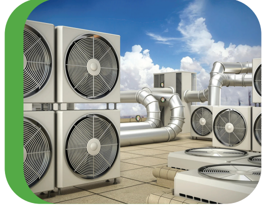
أعمال التبريد و التكييف
